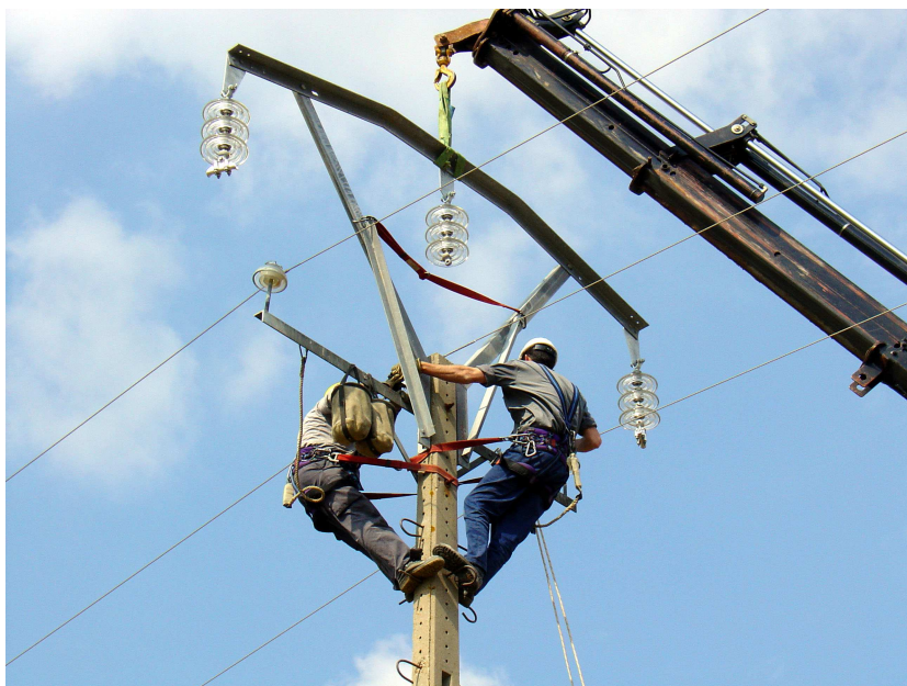
Operarios de Iberdrola realizando las correcciones en los conductores de una de las torretas.
